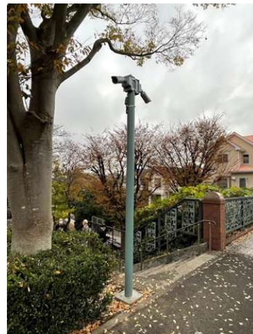
新設した通学路の防犯カメラ
